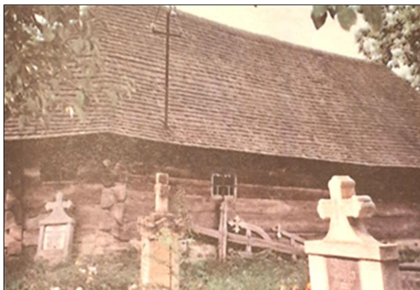
Biserica de lemn din satul Petea, pentru care trebuie demarate lucrări de conservare
