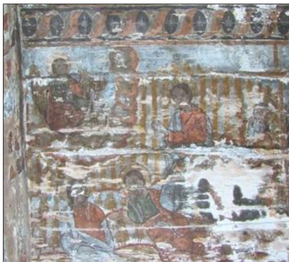
Porțiune din pictura interioară, grav afectată de apa de ploaie
